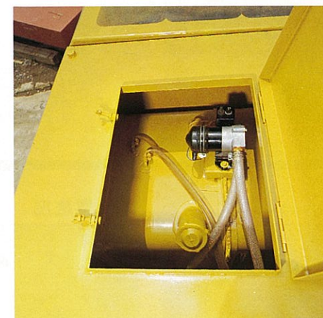
ビルジポンプ
